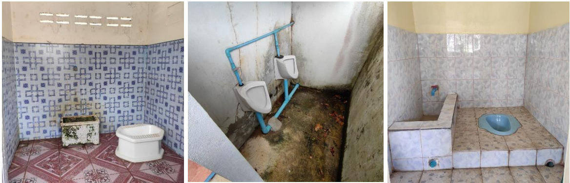
ภาพที่ 16 ตัวอย่างจุดเสี่ยงบริเวณห้องน้ำและห้องส้วมภายในวัดป่าหามาย
